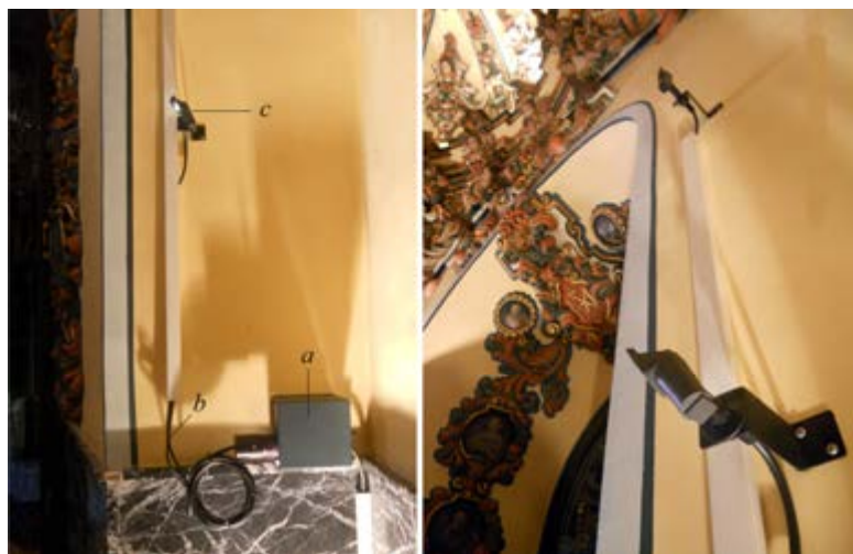
Figura 10. Sistema de iluminación de fibra óptica instalado en el camarín lateral izquierdo. a: Cajetín donde se genera la luz. b: cable de polimetilmetraquilado transmisor de la luz. c: puntos de proyección articulados. Archivo de Juan Antonio Aguilar Jiménez.
